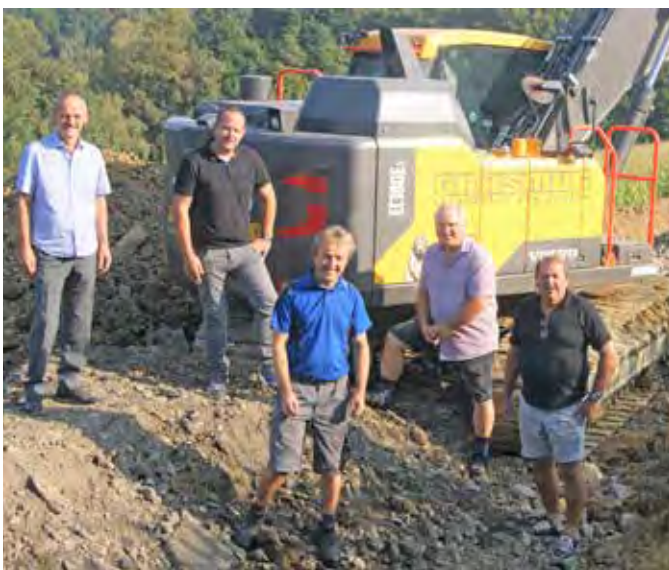
V.l.n.r.: Bgm. Johann Kaufmann, Wegbauobmannstellv. GR. Roland Ettl, Gemeindemitarbeiter Helmut Lindner, Gemeindemitarbeiter Johann Fasching und Wegbauobmann Vizebgm. Fritz Pferschi auf der Baustelle beim Löschnig-Zenz-Weg in Höllgrund.
