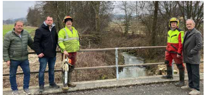
Wegbaureferent Fritz Pferschi, Wassermeister Manuel Prasl (Baubezirksleitung), die Facharbeiter Rudolf Urbanitsch und Eduard Urbanitsch mit Bürgermeister Johann Kaufmann bei der Baustelle beim Saßbachweg.
