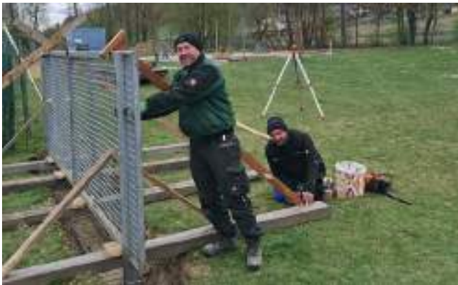
Helmut Lindner (vorne) und Reinhard Eder (hinten) bei der Errichtung der Zaunanlage beim neuen Bewegungspark.
