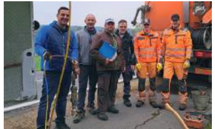
Klärwärter Manfred Schleich (3. v. l.) und Gemeindearbeiter Erich Glauininger (4. v. l.) mit Mitarbeitern der Firma Dietrich und WDL im Zuge der Digitalisierung der Kanalleitungen.
