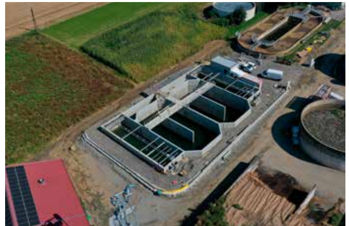
Das neue Klärbecken
