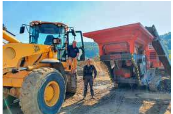
Johann Fasching mit einem Mitarbeiter der Firma Acht beim Recyceln von Bauschutt.
