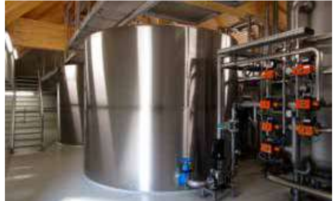
Im Inneren der Brunnenhäuser findet man modernste Technik.
