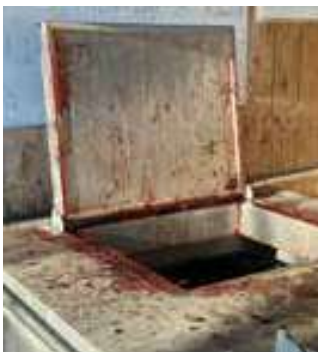
Es ist beschämend, wie blutverschmiert der TKV-Container (Kläranlage) hinterlassen wurde.
