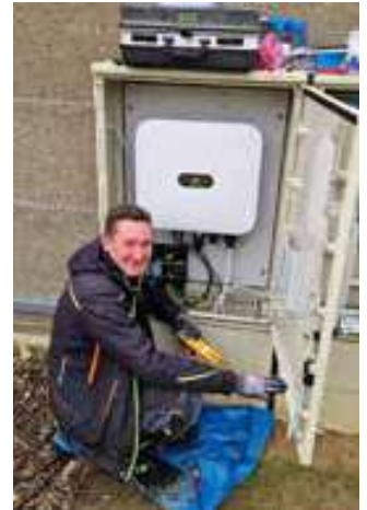
Andreas Hötzl bei der Installation der neuen PV-Anlage für die Haltestelle Friedhof.
