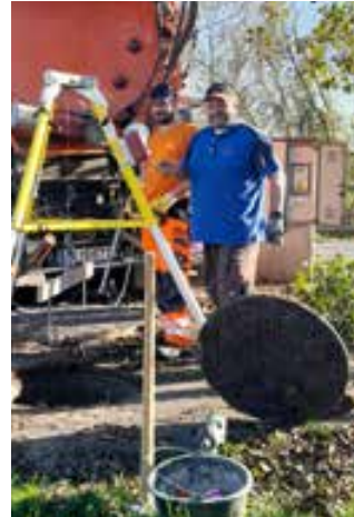
Reinigung der Kanalleitungen aufgrund von Verstopfungen.
